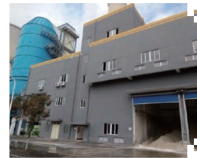
图为华润电力兴宁项目改造后新增的脱硫综合楼与脱硫吸收塔。兴宁项目投入资金8300万元实施脱硫、脱硝系统改造，改造后二氧化硫排放浓度由450mg/Nm 3 降至100mg/Nm 3 ，氮氧化物排放浓度由400mg/Nm 3 降至150mg/Nm 3 。
