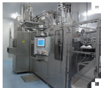
华润双鹤BFS内封式聚丙烯输液袋生产线
