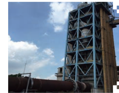
图为华润水泥珠江项目改造后的窑炉系统。珠江项目投资8000万元实施窑炉系统改造，改造完成后熟料标准煤耗由112.5kg/t.cl降低至105.3kg/t.cl、熟料工序电耗由26.8kWh/t-cl降低至24.5kWh/t-cl、熟料产量由5000t/d提高到5433t/d。
